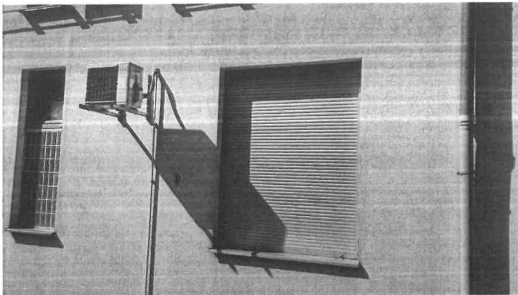
Fot. 3. Jednostka zewnętrzna z tyłu budynku, w rejonie zjazdu do hali garażowej.
