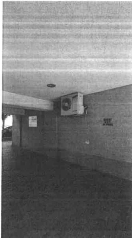
Fot. 1. Jednostka zewnętrzna klimatyzatora w prześwicie budynku przy ul. Konfederackiej.
