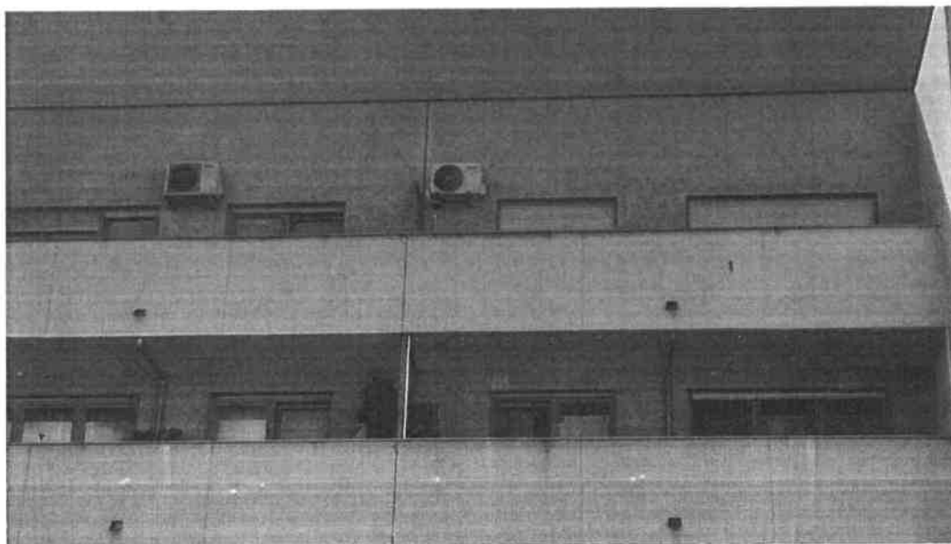
Fot. 4. Dwie jednostki zewnętrzne na najwyższej kondygnacji budynku naprzeciw siedziby PTBS.
